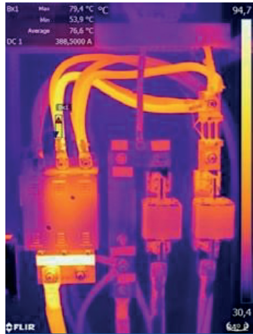
Termogramma in ambito elettrico per la diagnosi di un teleruttore con contatti difettosi
