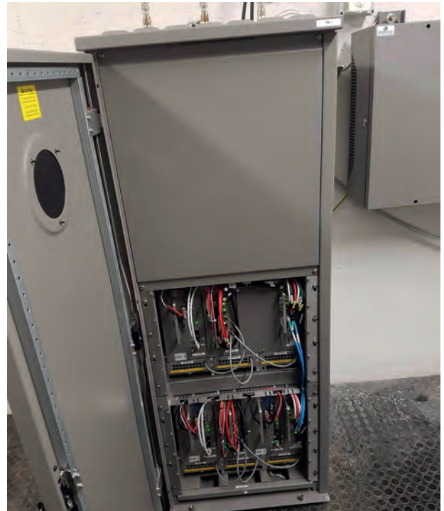
Impianto radio TETRA di Motorola Solutions
