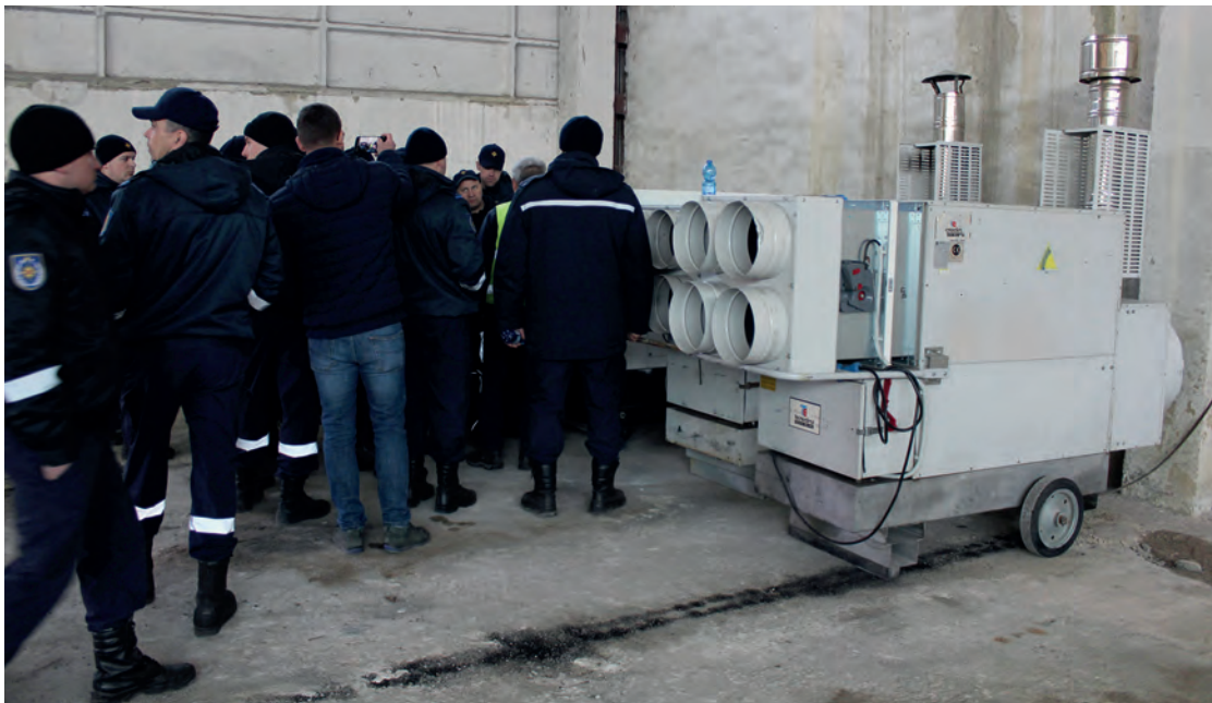
I due potenti riscaldatori per la tensostruttura sociale di m 12 x 60 collocati nel capannone
