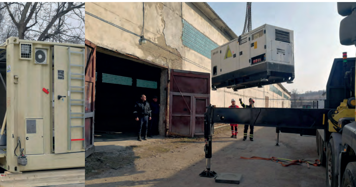
La cucina da campo. Il suo generatore da 108 Kwatt, viene collocato al chiuso dentro il capannone
